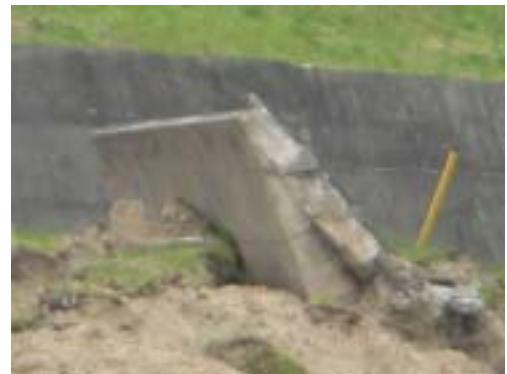
写真 13: コンクリート擁壁の滑動 (栗原市内)
