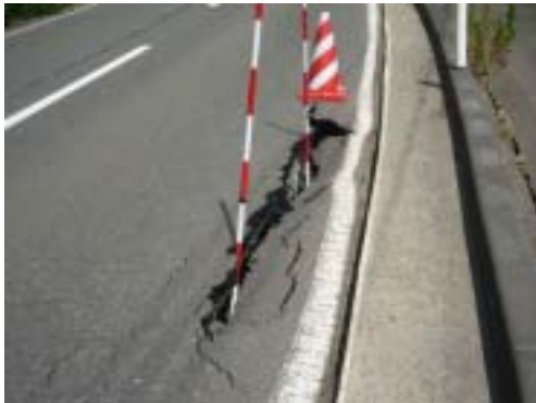
写真 9:道路に発生したクラック(奥州市内)
