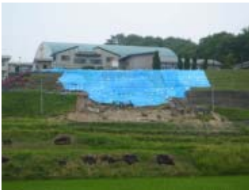
写真 12: 法面の崩壊 (栗原市内)
