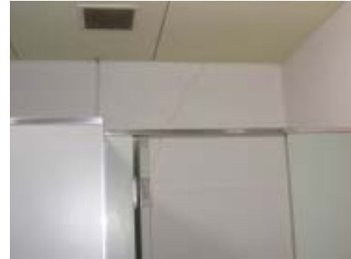
写真 7: 壁クラックの発生(栗原市内)
