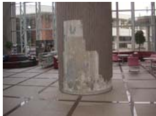
写真 5: 柱タイルの剥落(栗原市庁舎内)
