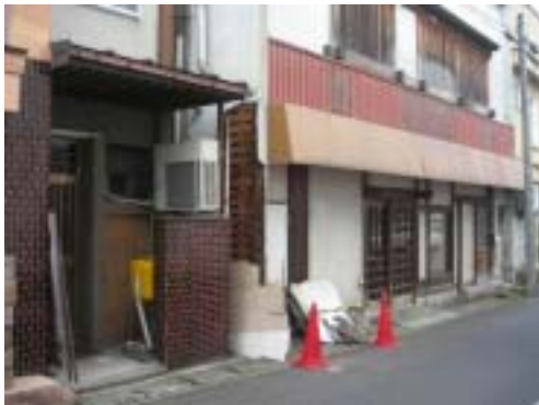
写真 6: 壁材の剥落(栗原市内)
